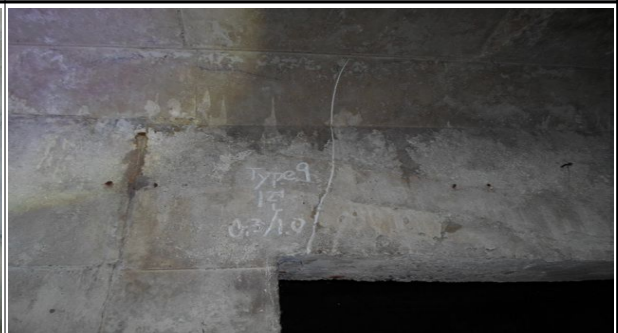
Type-9 J80~J81 균열
