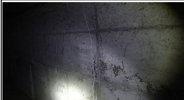
Type-12 J110 균열
