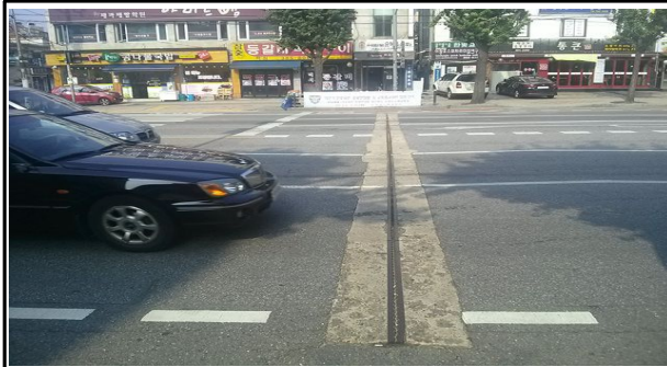
신축이음 J94 후타재 파손
