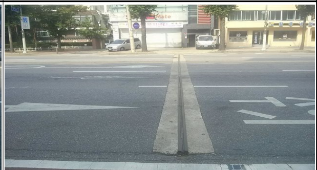
신축이음 J88 후타재 파손
