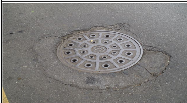
포장부 J14~J15 맨홀부 주변 파손
