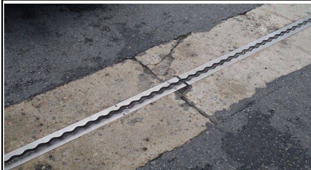
신축이음 J26 후타재 파손
