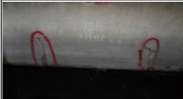
Type-8 J79~J80 보수부 파손
