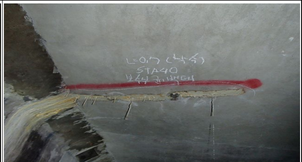
Type-1 1련 보수부 균열,백태
