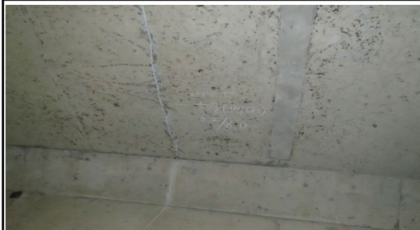
Type-1 J07~J08 균열(백태)
