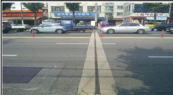
신축이음 J77 후타재 파손
