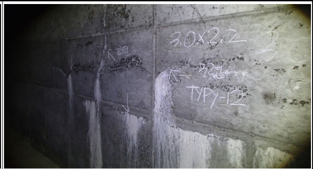
Type-12 J110 백태 및 균열
