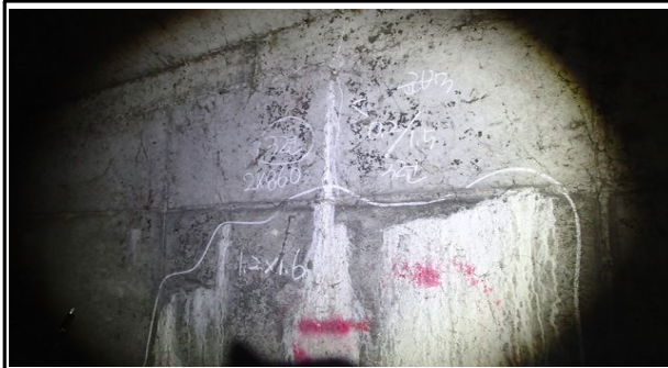
Type-12 J110 백태 및 균열
